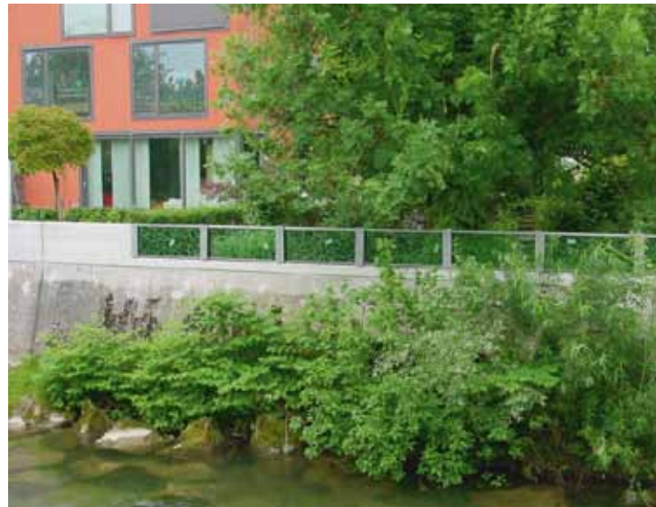
Hochwasserschutzwand mit Sicherheitsglas
