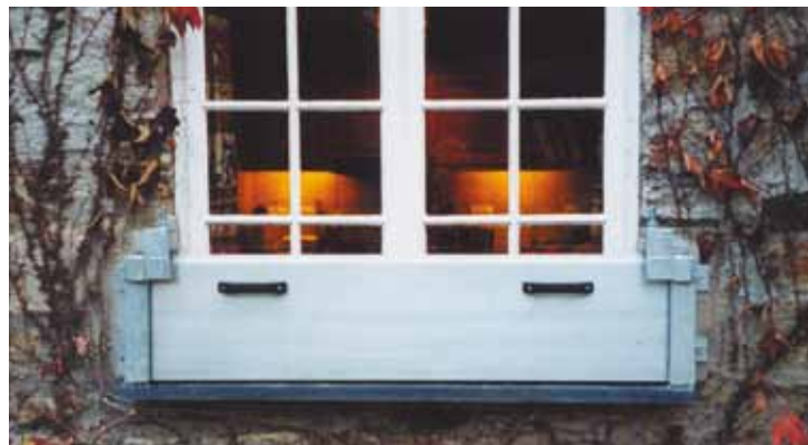
Hochwasserschutz an Fensteröffnungen
