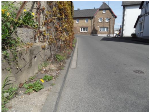
Bild 25: Nicht vorhandener Bürgersteig vor Ließemer Straße 1
