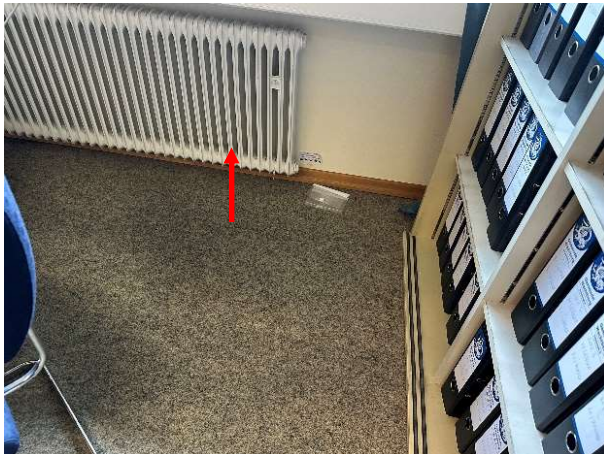
Abbildung 10: Vorgefundene Rippenheizkörper (links) und FH-Türen (rechts)
